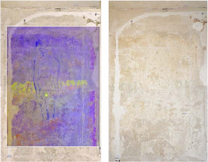
Nordwand, links Montage mit Falschfarbenaufnahme, rechts Befundsituation, 2020
